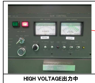
HIGH VOLTAGE出力中
